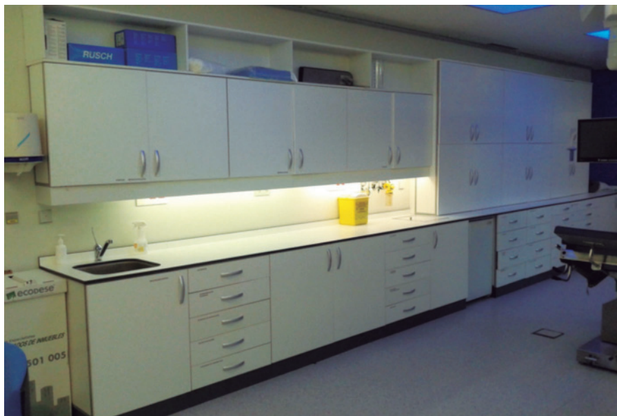
Figura 6. Armarios para material y encimera de trabajo con iluminación regulada.
